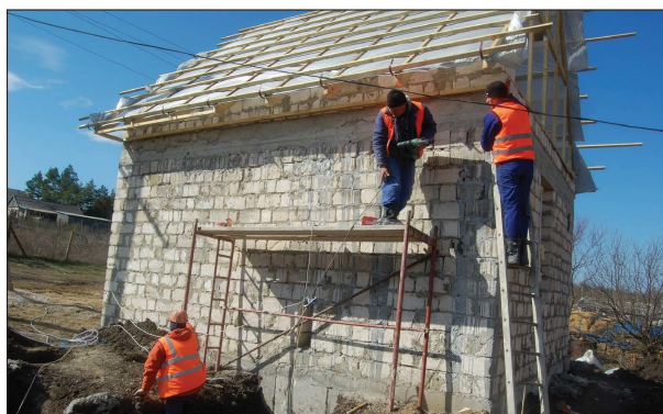
Construirea clădirii pentru utilajul noului sistem termic de la Grădinița din satul Maximeni, raionul Cimișlia
